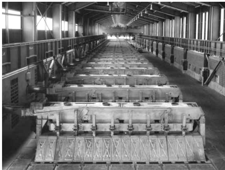
Figure 6 : Photographie d'une série de cuves d'électrolyse
